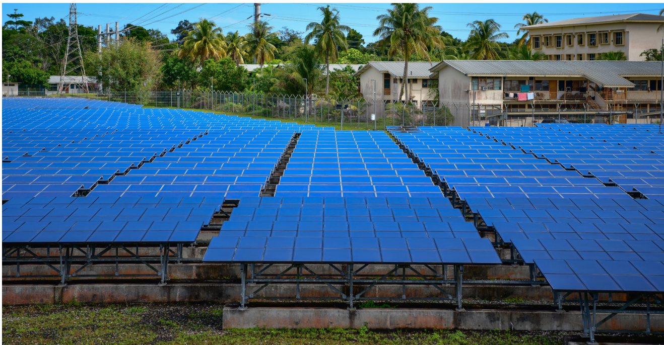
Loji Tenaga Suria Brunei, loji yang pertama dan satu-satunya Loji Tenaga Fotovolta (P) di Brunei Darussalam, dikendalikan dan diselenggarakan oleh Jabatan Perkhidmatan Elektrik, Jabatan Tenaga, Jabatan Perdana Menteri.
